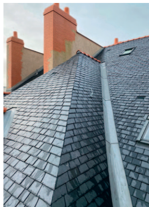
Noue à bandes de zinc, © Blondy Couverture
