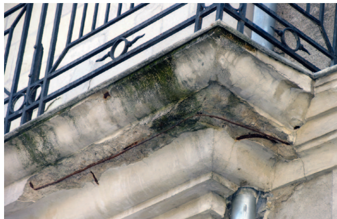
Corniche sous balcon dégradée, © Elisabeth Pérot
