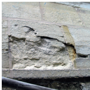
Pierre éclatée par infiltration
