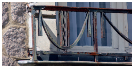
Ouvrage nécessitant une restauration, rue Yves-Bodiguel
