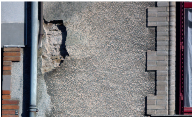
Décollement d'enduit ciment sur mur de schiste, © Elisabeth Pérot
