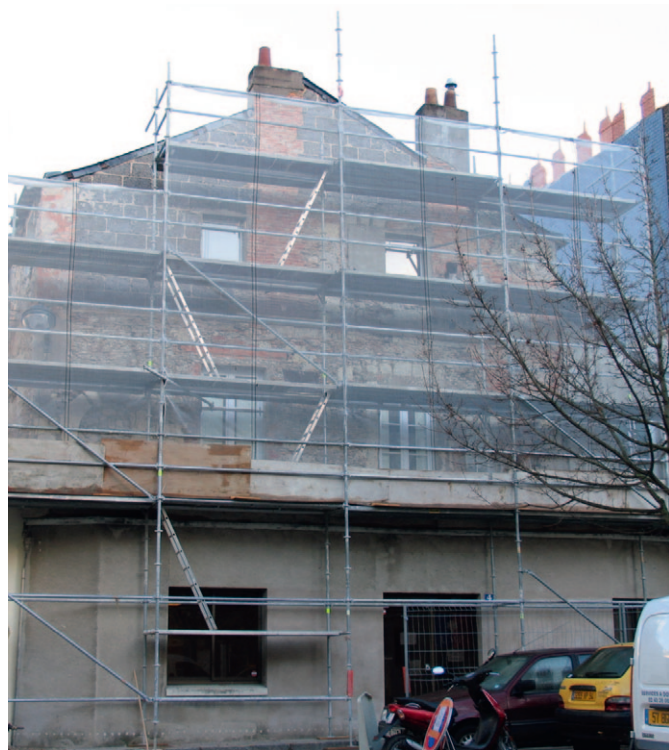
Echafaudage et filets de protection sur un chantier de ravalement de façade
