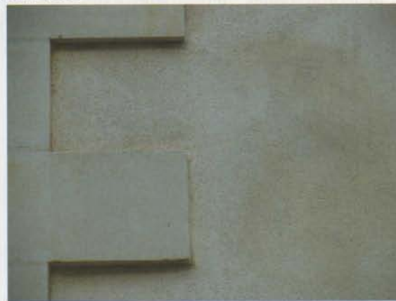
Laitance de chaux laissée en surface
