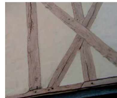
Détail de l'assemblage de pans de bois (structure en bois et remplissage)
